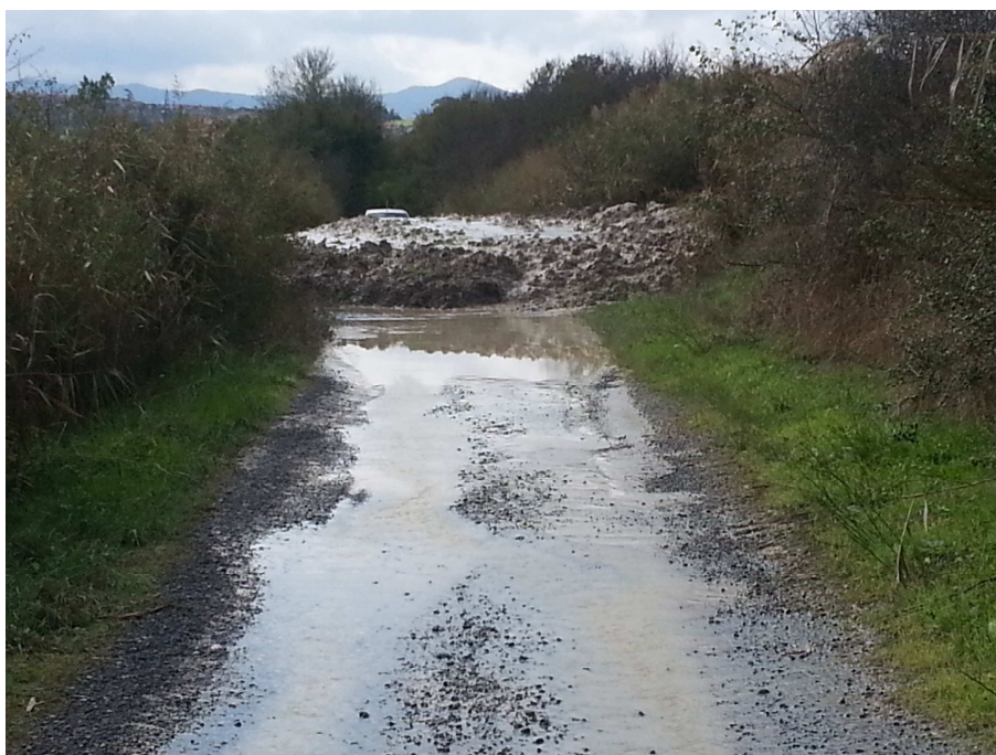
Frana di colamento su viabilità secondaria (24/10/2013)
