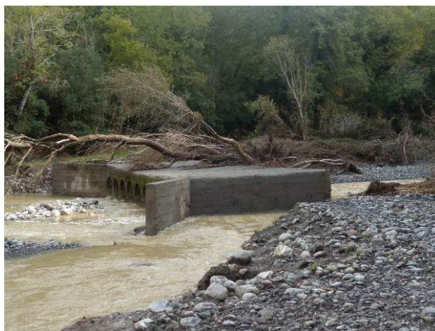
Interruzione di viabilità secondaria su Torrente Sellate (21/10/2013)
